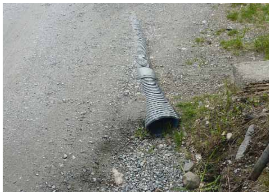
Hver enkelt huseier er ifølge veiloven pliktig til å sørge for drenering under innkjørselen og vedlikehold av denne.
